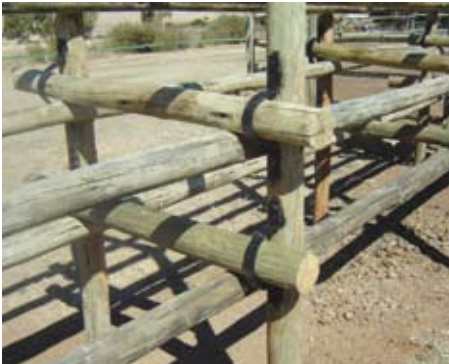
Die D-ringe waarmee die perde afgeskort word, word vooraan die regop paal vasgebout om dit stewiger te kry. Gebruik 30 mm breë plat yster
